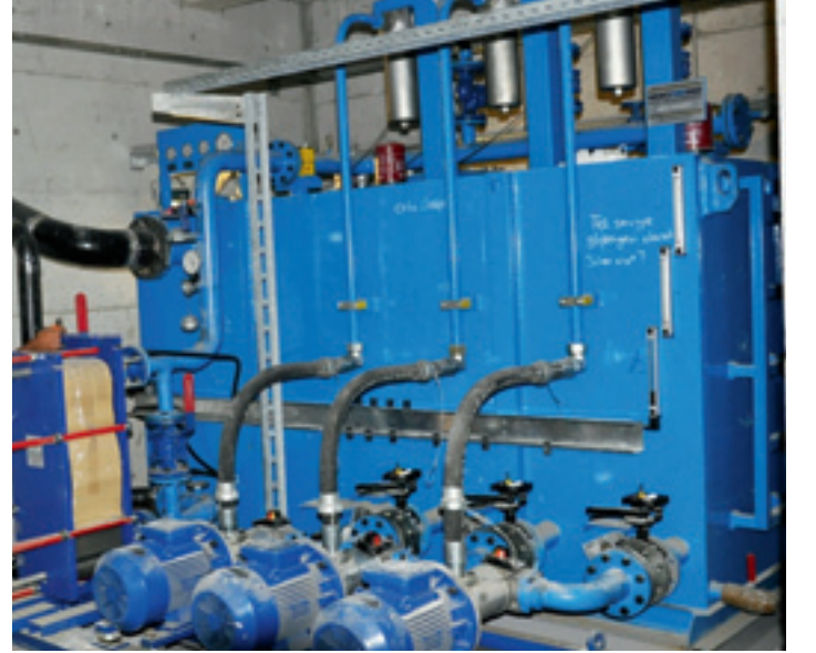
YAĞLAMA ÜNİTESİ (Lubrication Unit)
